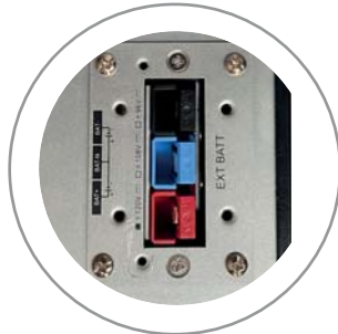
Conector de banco de baterías
