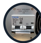
Breaker de entrada
