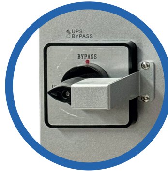
Conmutador de BYPASS de mantenimiento
