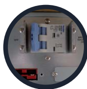
Breaker de baterías
