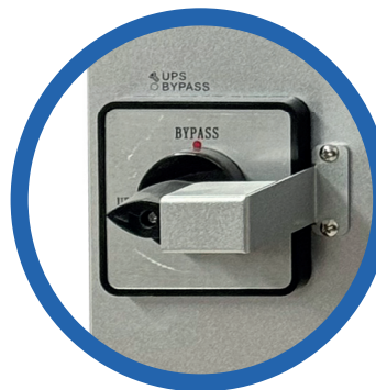
Conmutador de BYPASS de mantenimiento
