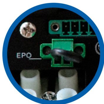
Apagado de Emergencia (EPO)
