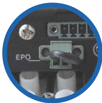
Apagado de Emergencia (EPO)
