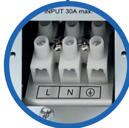
Block de terminales
