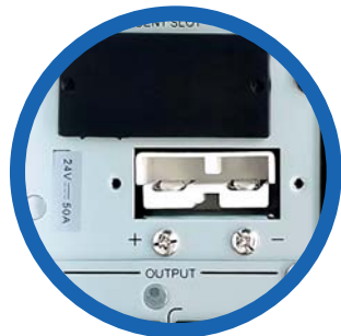
Entrada banco de baterías externas
