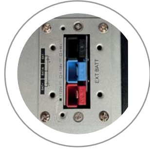
Conector de banco de baterías
