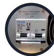
Breaker de entrada
