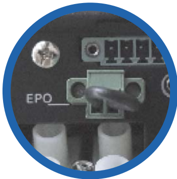
Apagado de Emergencia (EPO)
